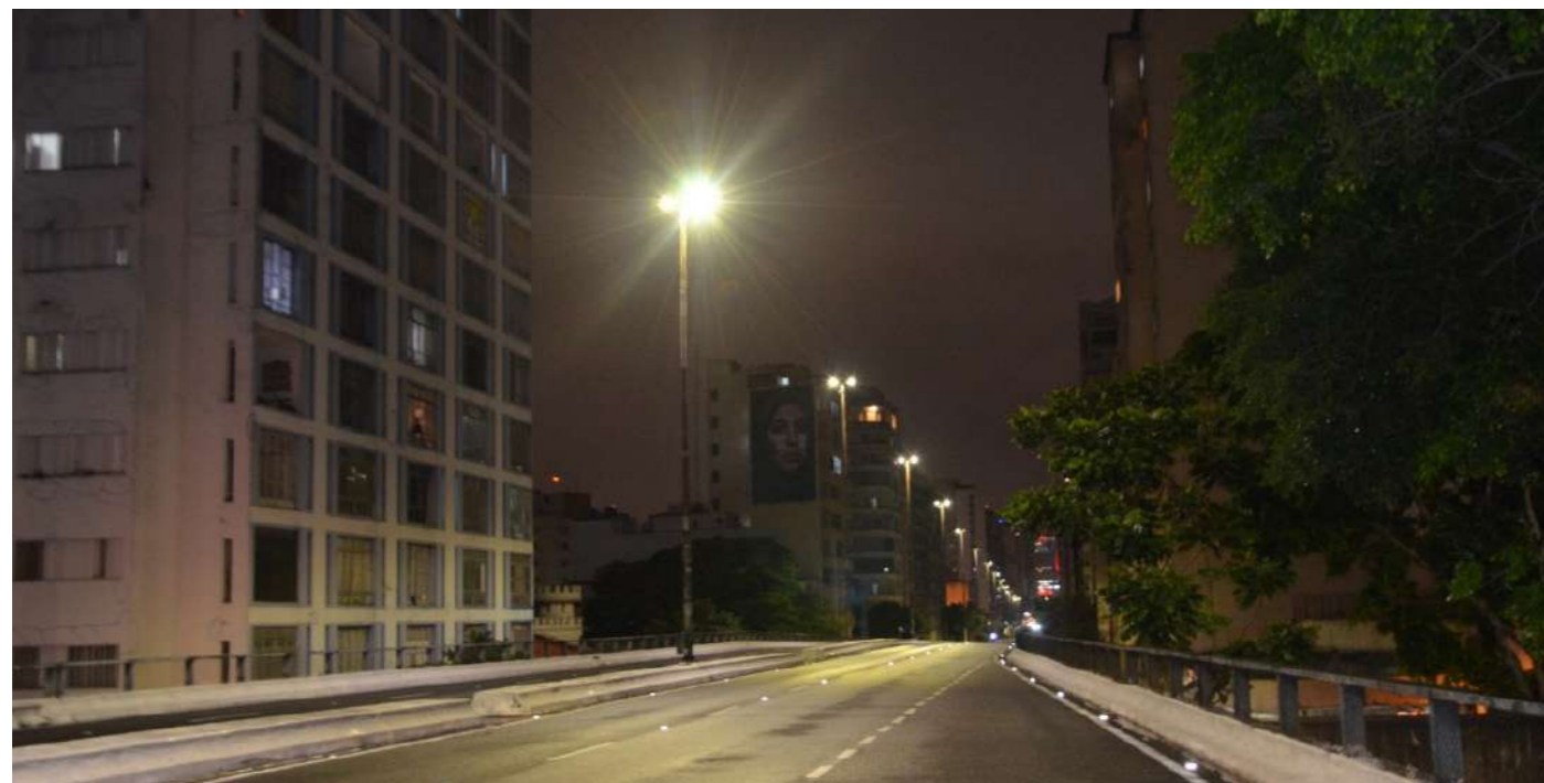
Instalação de luzes de LED na iluminação dos postes de rua de São Paulo.
